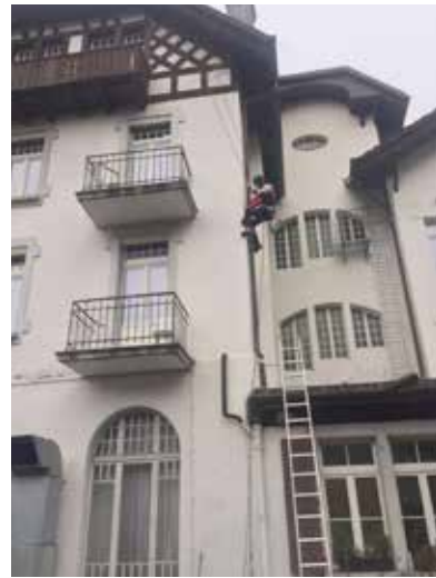
Der Blitzschutz ist montiert
